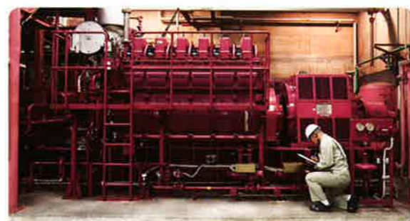
非常用発電機 (ガスエンジン)
